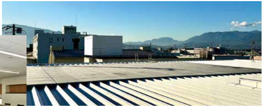
本社事務所屋上に設置した太陽光発電パネル
